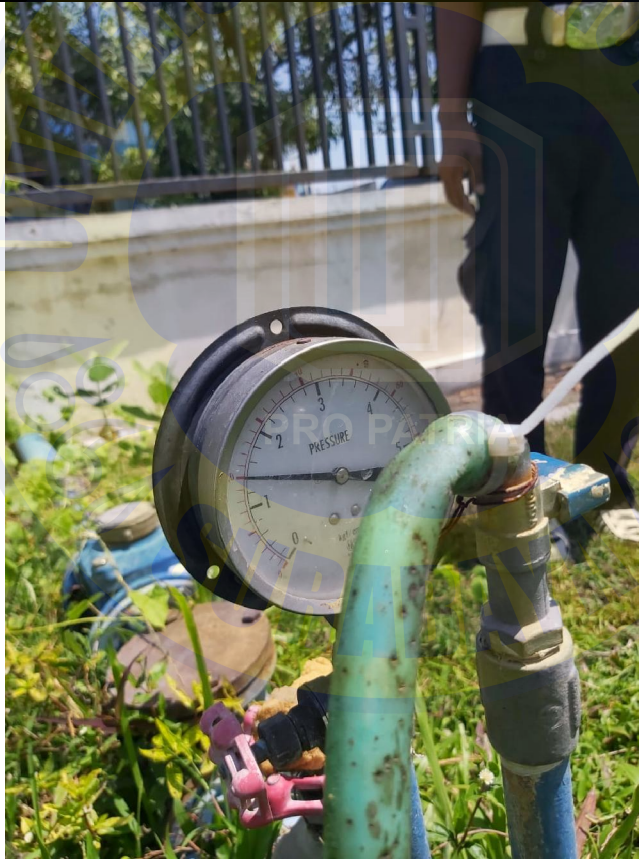
Salah satu bar gauge di meter milik pelanggan industri PIER
