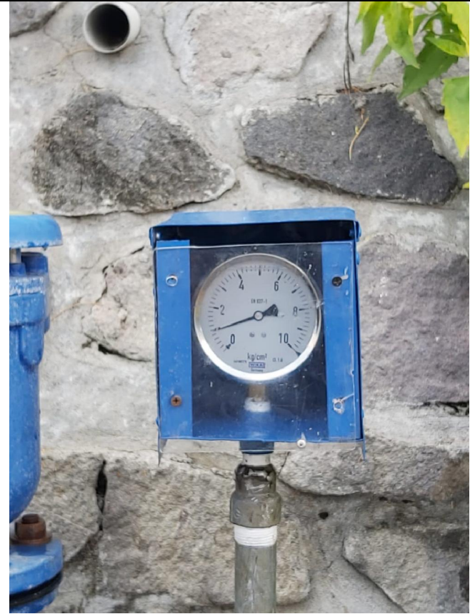
Bar Gauge yang ada di perpipaan distribusi kawasan PIER
