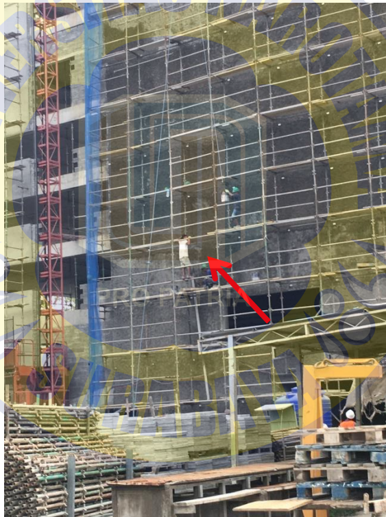
Gambar 4. Pekerja Sedang Bekerja Dan Tidak Menggunakan pakaian Kerja (APD)
