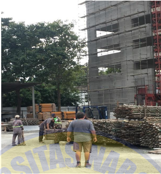
Gambar 5. Pekerja Sedang Bekerja Dan Tidak Menggunakan Pakaian Kerja (APD)
