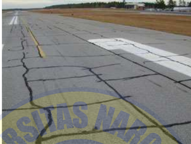
Gambar 2.3 Retak kotak ( Block Cracking )
