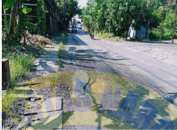
Gambar 1.1. Kondisi Jalan Lokasi Penelitian Menandakan Terjadi Kerusakan Lubang
