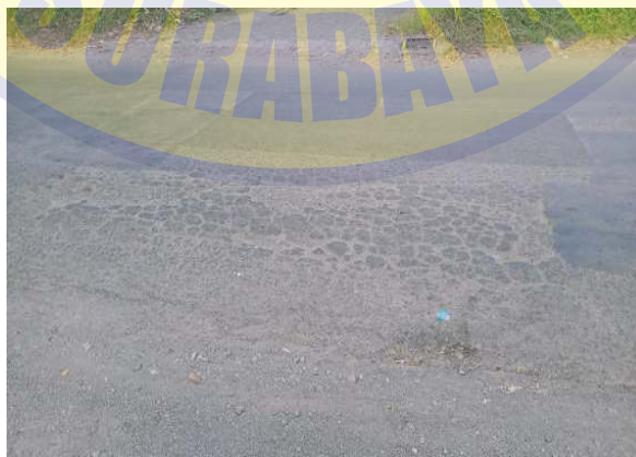
Gambar 1.5. Kondisi Jalan Lokasi Penelitian Menandakan Terjadi Kerusakan Retak Kulit Buaya dan Tambalan
