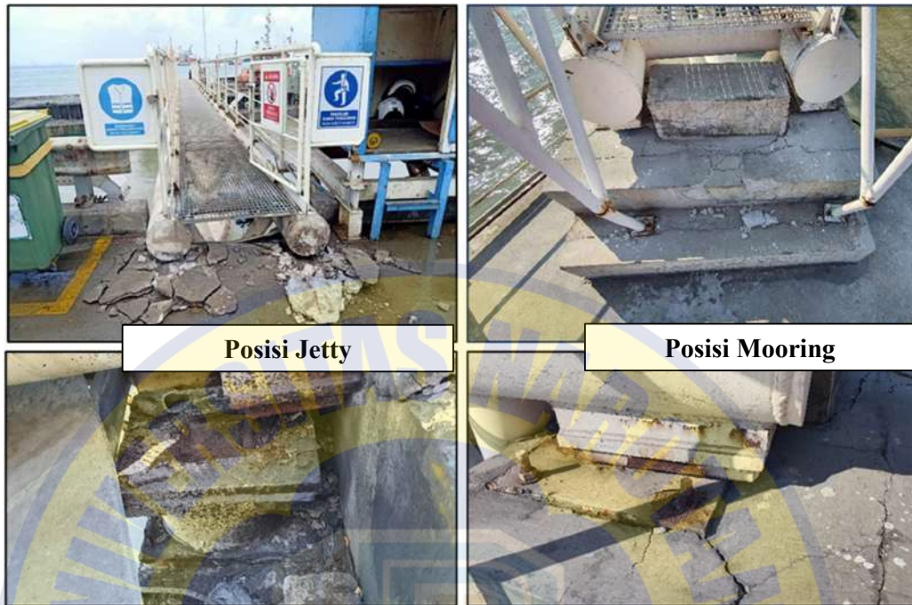
Gambar 1.2. Kerusakan pada Perletakan Catwalk
