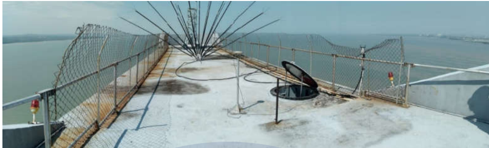
Gambar 4.10.1 Pemasangan pagar pengaman yang tidak ergonomi
