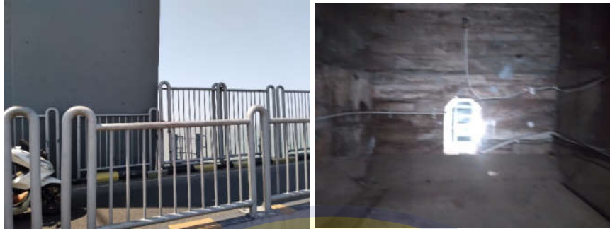
Gambar 4.7 lokasi yang tidak terdapat rambu peringatan
