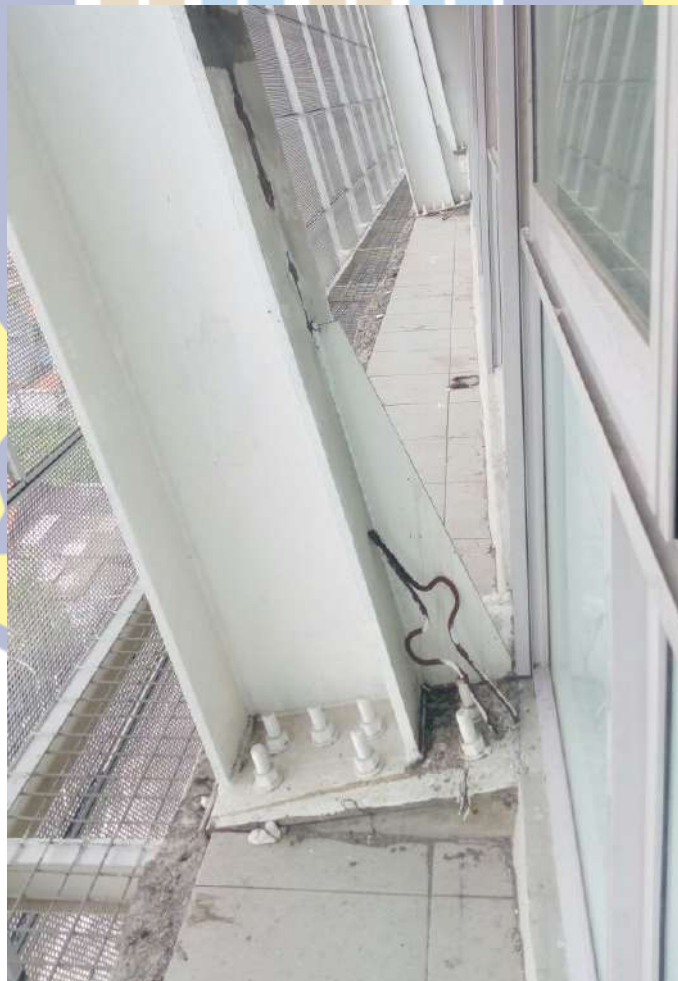
Gambar 4.191. Foto hasil kolom miring gedung P1 & P2 dilapangan
