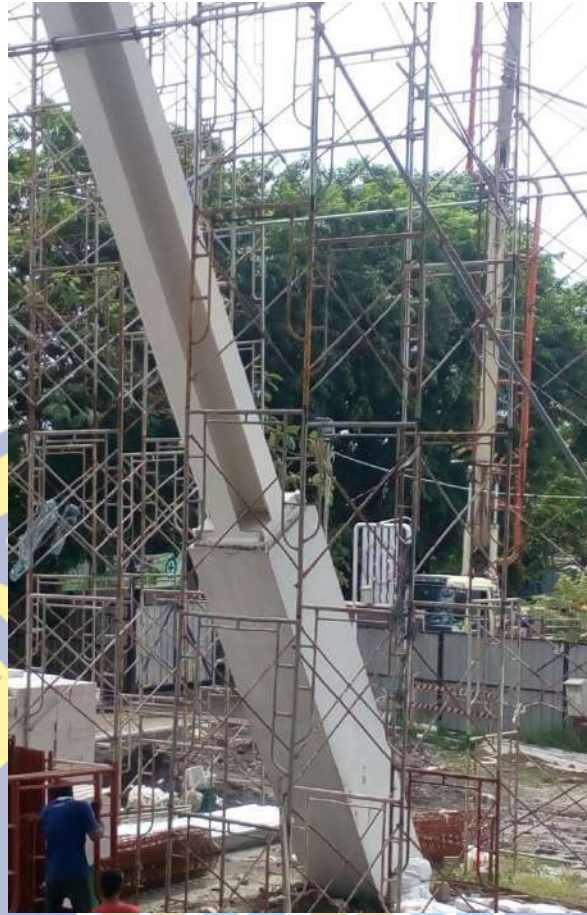
Gambar 4.185. Foto hasil kolom miring gedung auditorium dilapangan
