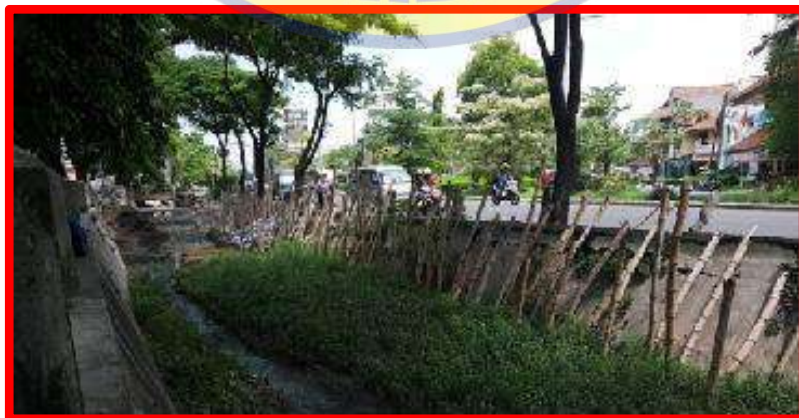
Gambar 4.2 Kondisi existing turap di Jl. Wiyung-Babatan depan Perumahan Pratama Estate Sumber: Dokumentasi Pribadi
