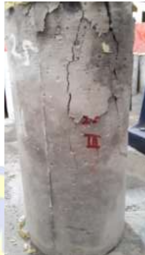
Kerusakan pada kode uji 25%
