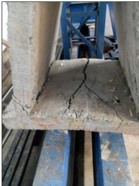
Gambar 7.11 Keretakan Fondasi Bagian Dalam Dasar
