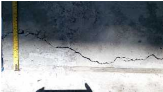
Fig. 9 Crack Wall Fondation
