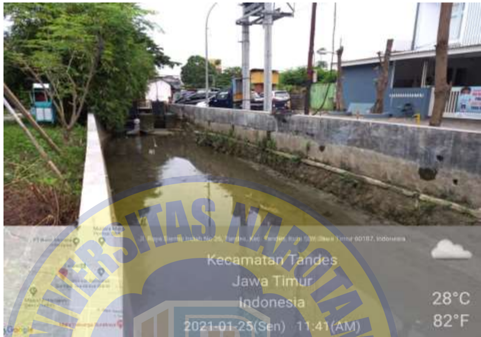
Gambar 1.1.7 Pintu air di saluran darmo
